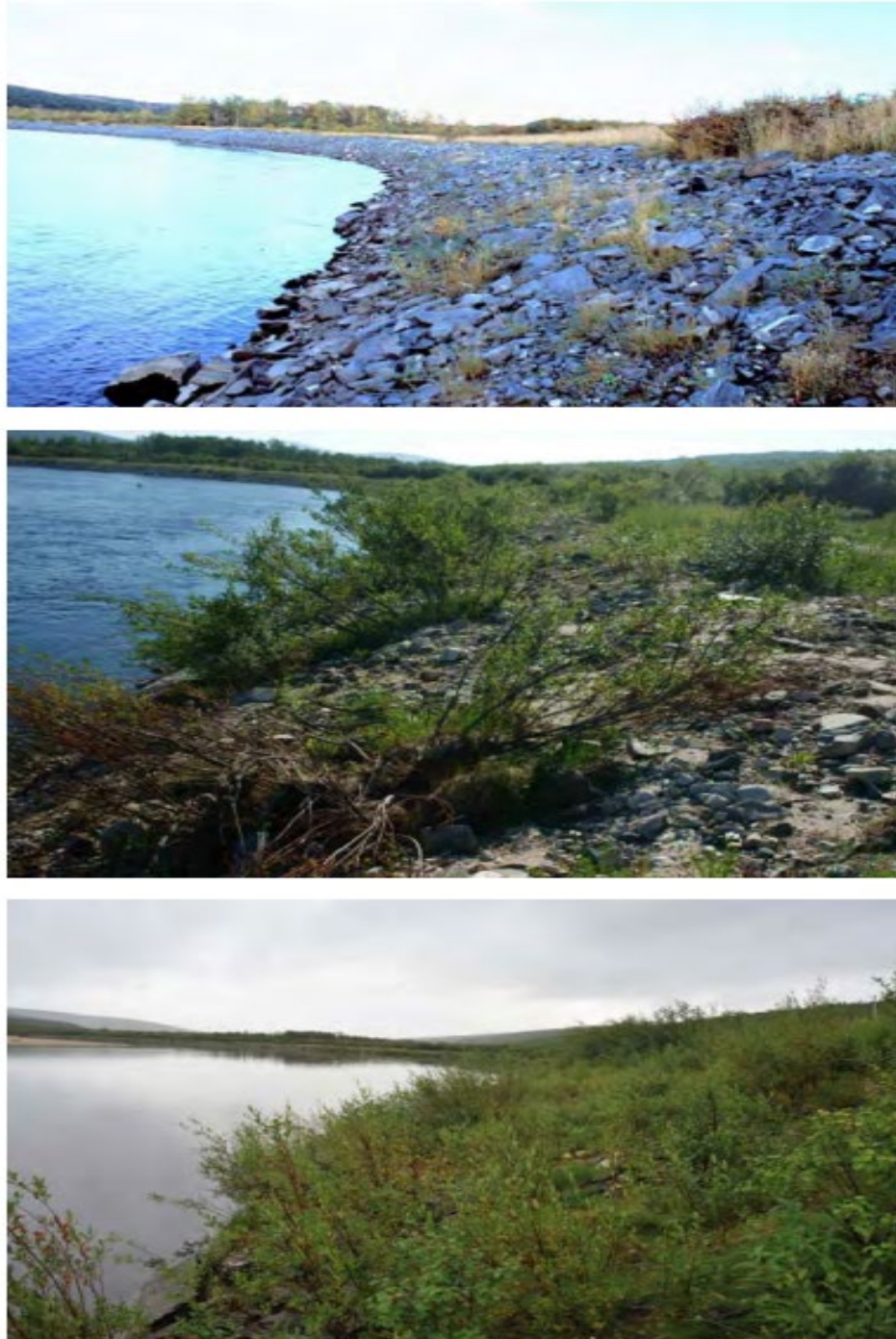
Figur 19. Eksempel på revegetering av erosjonssikring ved Jeabmelsnjarg i Tanaelva, Finnmark. Øverst er tilstanden etter første påfølgende flom etter konstruksjon av erosjonssikringer. Midterste bildet er rett etter at erosjonssikringen ble tildekket med jord, vegetasjonsmatter og klynger av mindre trær. Nederste bilde er 4 år etter revegeteringstiltak. Bildet er lånt fra NVEs veileder 29, 2014 (NVE 2014). Foto: Gunnar Kristiansen, NVE.
