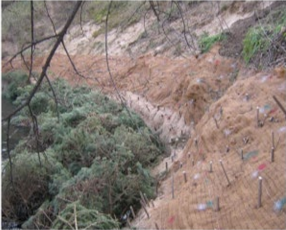
Figur 22: Eksempel på hvordan geotekstil i kombinasjon med treplugg/stiklinger kan brukes for å stabilisere erosjon langs en elvebanke. Illustrasjonen er hentet fra "A Guide to Bank Restoration Options for Large River Systems: Part II Bioengineering Installation Manual", (Mississippi watershed management organization 2010)
