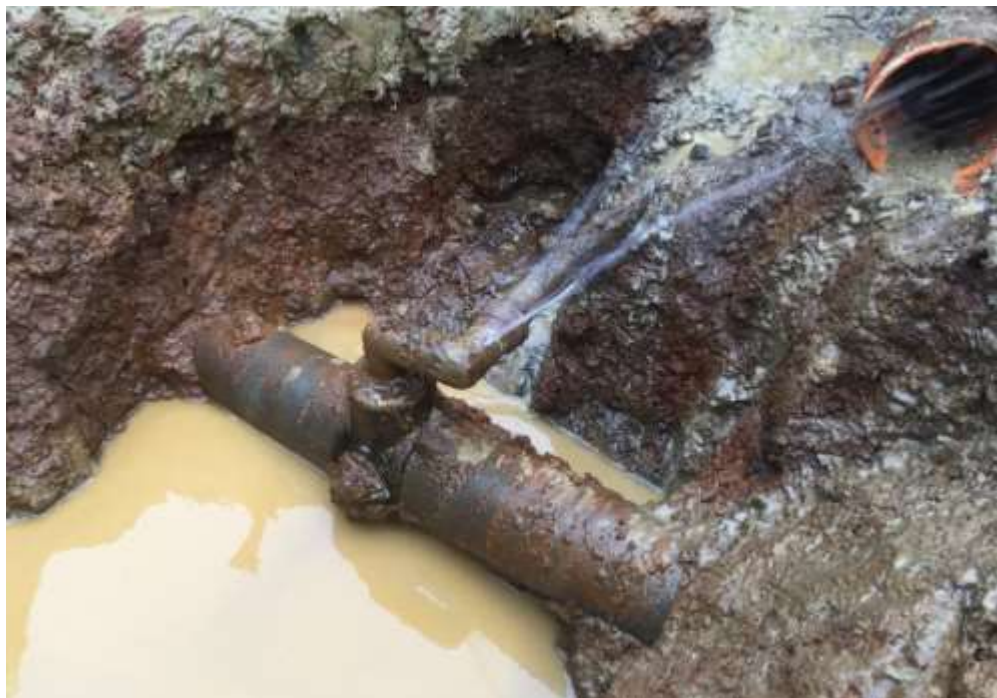
Figur 6-18 Bilde fra lekkasjesøking
