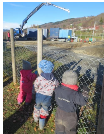
Til venstre ser vi at riggen for arbeid på Fjerdum skole og barnehage klargjøres. Unger i Fjerdum barnehage følger spent med!
