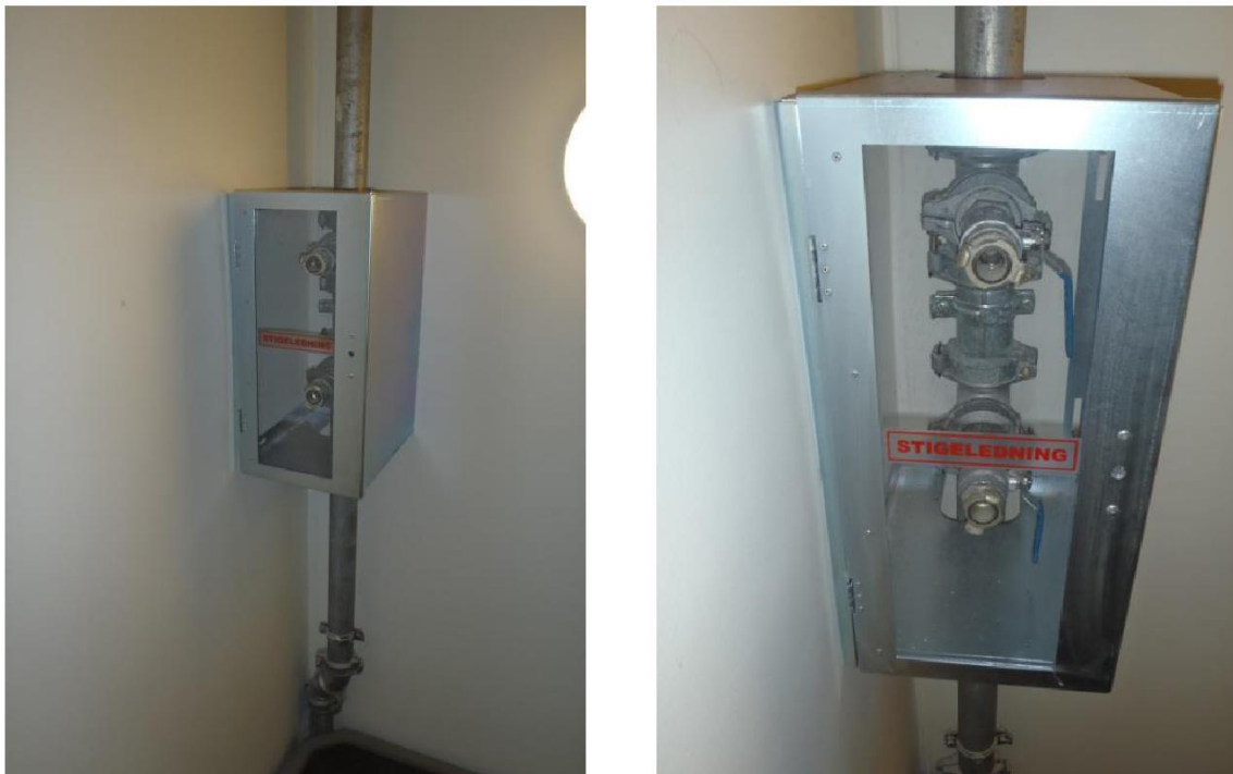
Figur 9 Godt eksempel på skap for beskyttelse av stigeledning/tørropplegg mot hærverk.
